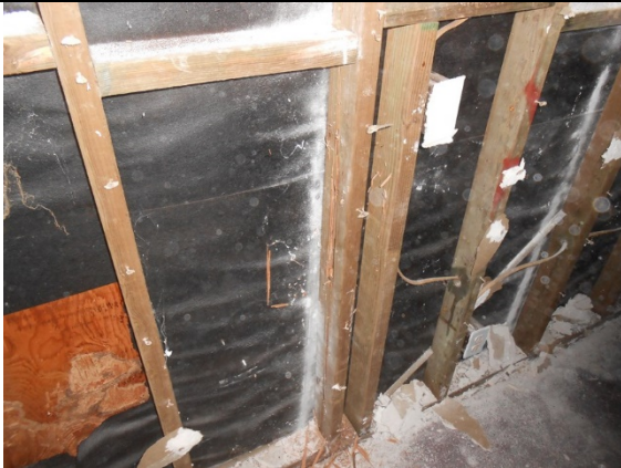
PC1D.5: Stud termite damage.
