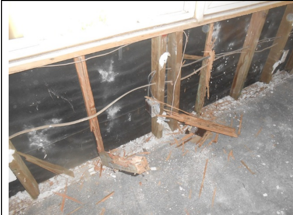
PB2D.4: Stud termite damage.
