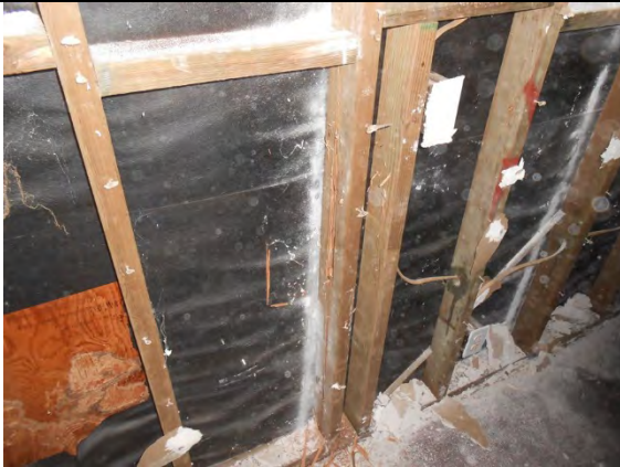
PC1D.5: Stud termite damage.
